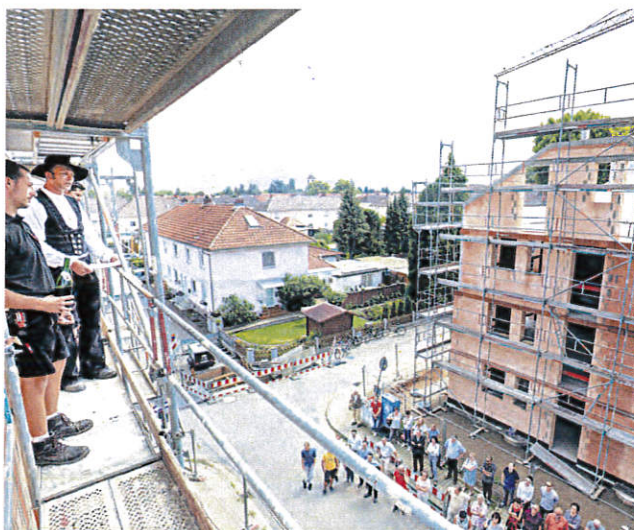
Im Möwenweg erstellt die Baugenossenschaft Neu Heidelberg vier Mehrfamilienhäuser als Ersatz für Altbauten. Jetzt wurde Richtfest gefeiert. (Foto Rothe)
